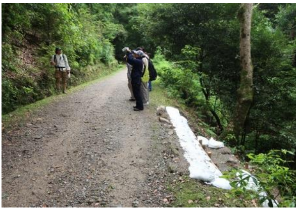
手前の土嚢は、6月豪雨の際に崩落
